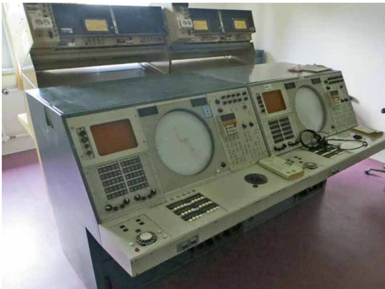
MFS bzw. GFN-Konsolen der Firma Hughes. Die mit diesen Geräten ausgestatteten Stellungen Glons, Niew Milligen, Uedem und Brockzetel waren die ersten CRC des NADGE-Zeitalters.
