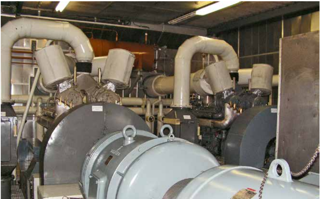
Blick auf zwei Notstromaggregate
