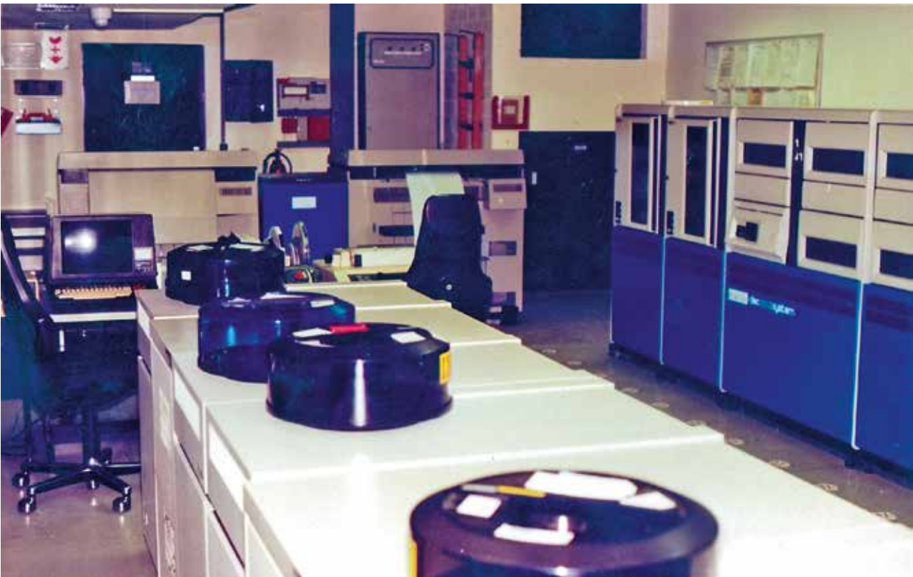
Blick in das Rechenzentrum des Programmierzentrums der Luftwaffe für Luftverteidigung im Gebäude 16
